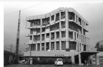
被災した熊本県宇土市役所
