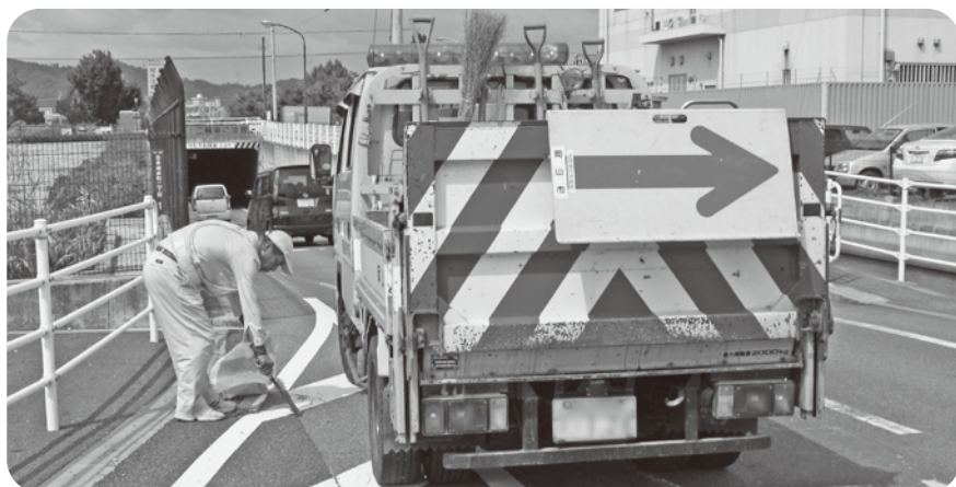
速やかな道路修繕で交通安全を確保
