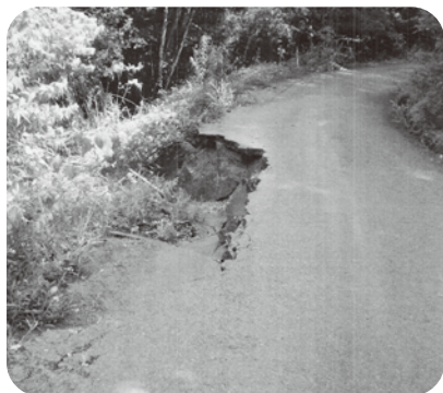
豪雨被害で崩落した道路
