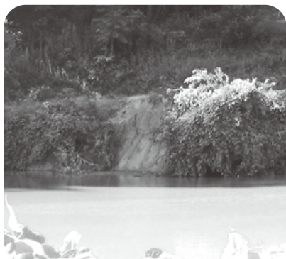
台風18号でのり面が崩れたため池
