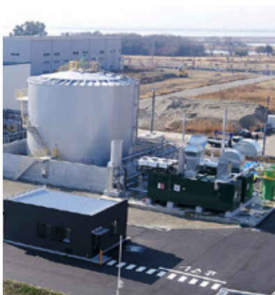
バイオガス発電施設
