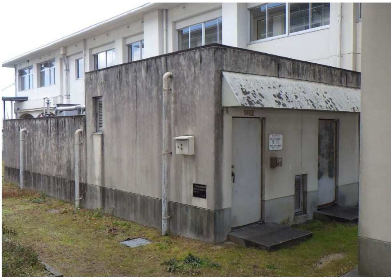
位置番号：⑫浄化槽機械室
