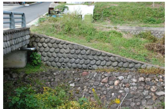
（残念な例）化粧型枠を使った擬似玉石積は味気ない 安易な化粧（修景）はだめ、造形で形を整える
