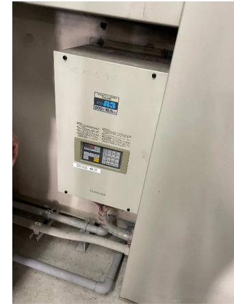
②オイルサービスタンク流量計
