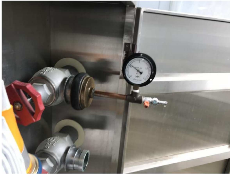
北側R F 放水口
