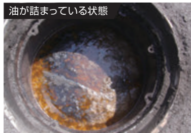
油が詰まっている状態
