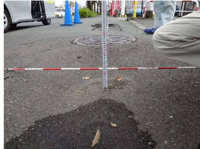
マンホール付近が約10cm陥没
