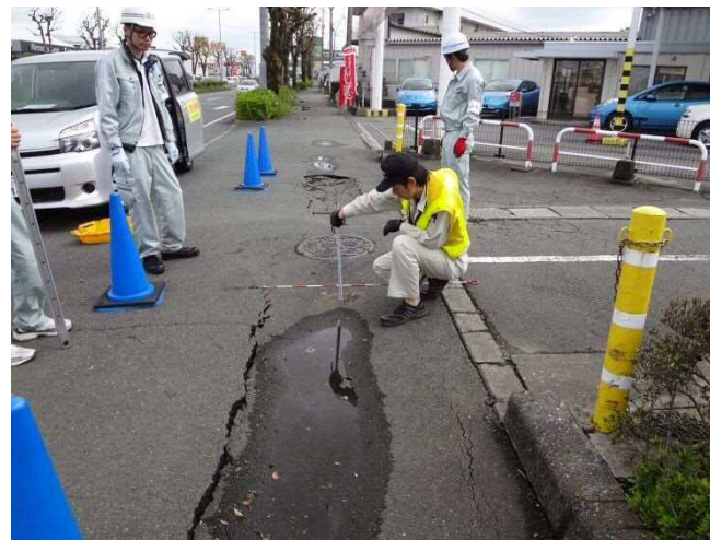
被害状況の調査
