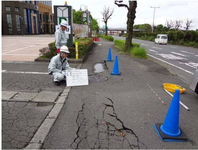
被害箇所の全景
