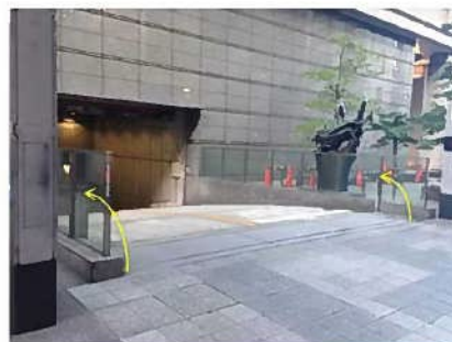
地下駐車場にアクセスするスロープ⇒起伏式止水板 （竣工時から設置）
