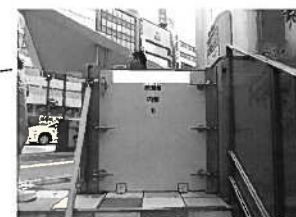
浸水深の深い東側は防水板（脱着式）を採用
