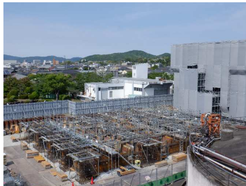
自家発電変電棟
