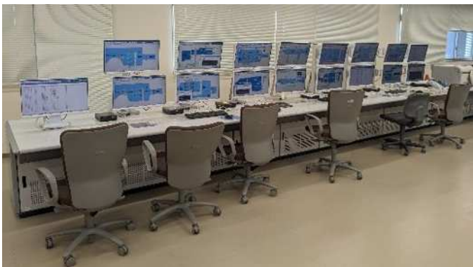
旭西排水センター新管理棟（内部）
