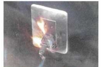
トラッキング火災の様子。
