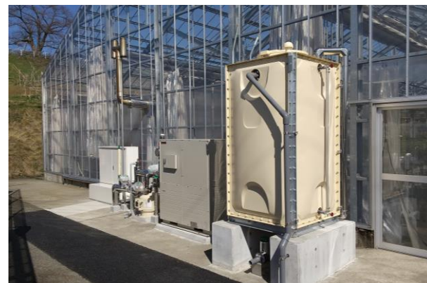
空調ヒートポンプ（中央） 井水受水槽（手前）
