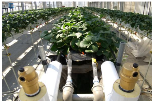
クラウン加温配管
