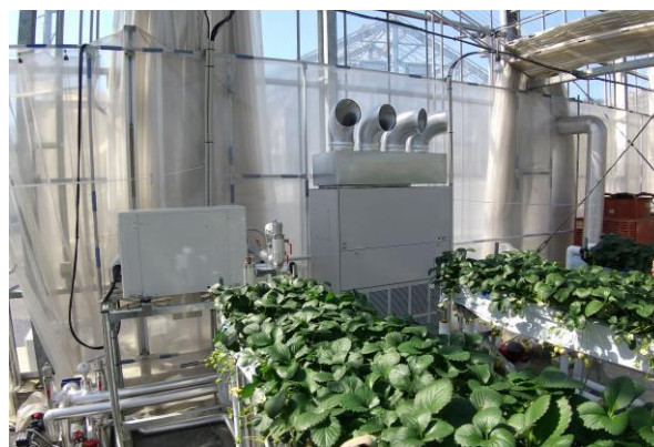
クラウン加温用ヒートポンプ（左） 空調ヒートポンプ室内機（右）
