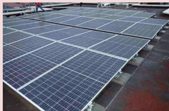
太陽光発電設備
