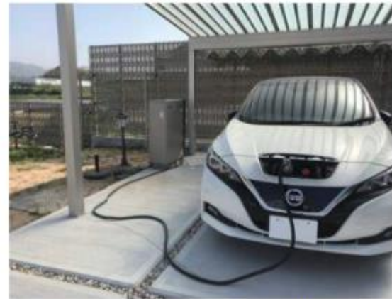
(導入事例：ことづくり生活発電所 (香川県高松市)) (三菱電機 EV用パワーコンディショナ SMART V2H)
