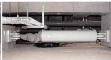
免震装置（オイルダンパー）
