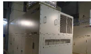
非常用発電機の設置（2階）
