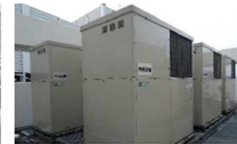
常用非常用兼用発電機（2階屋外）
