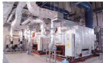
エネルギーセンター（2、3階）
