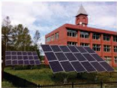
避難所に設置した太陽光発電
