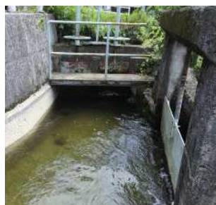
高梁川の支流から水路への取水口
