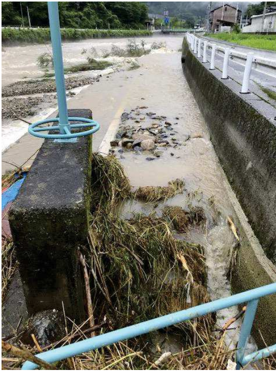
一級河川高梁川の取水口
