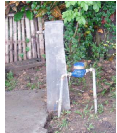
水道栓と メーター
