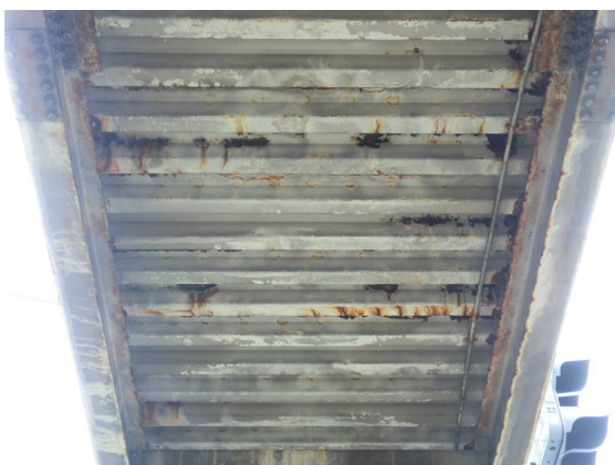
主桁やデッキプレート床版の塗膜劣化, 腐食
