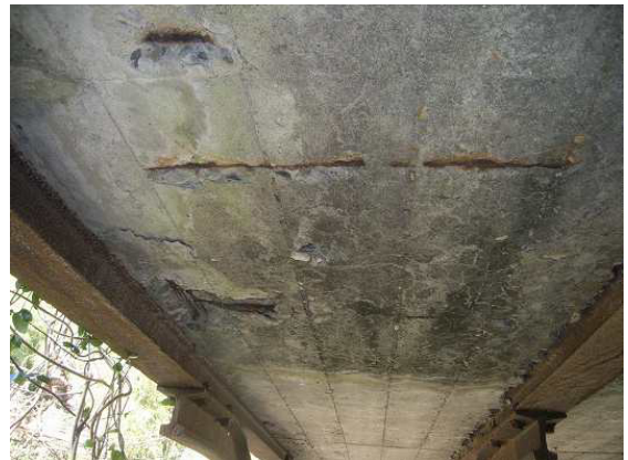
床版コンクリートの鉄筋腐食による剥落
