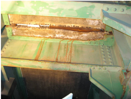
床版からの漏水による桁の腐食
