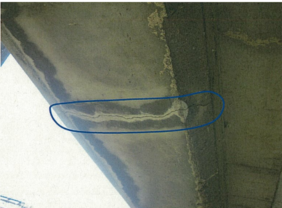
床版のひび割れと漏水による遊離石灰
