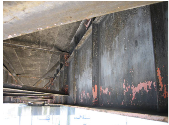
塗膜の経年劣化
