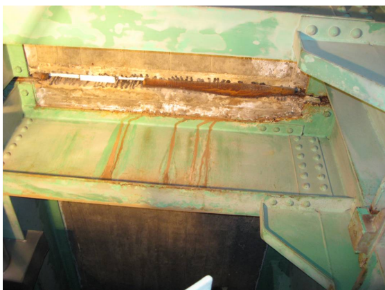
床版からの漏水による桁の腐食
