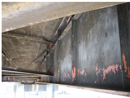
塗膜の経年劣化
