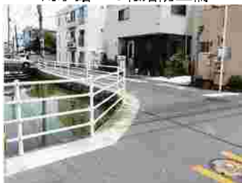
用水路への転落防止柵
