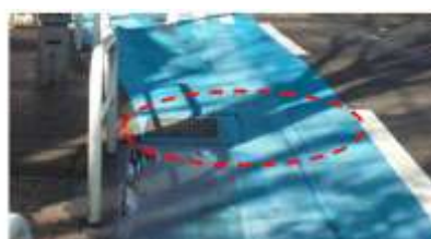
走行空間上にグレーティング蓋が存在し、車輪がはまったり、すべったりする恐れがある
