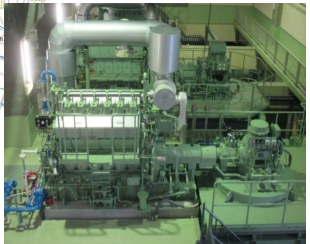
増設したNo.4雨水ポンプ全景
