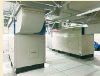
▲5階の発電機室に設置された 非常用発電機
