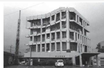
被災した熊本県宇土市役所
