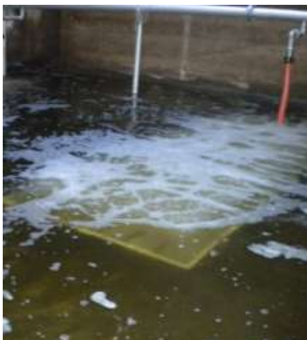
岡東処理場の散気装置
