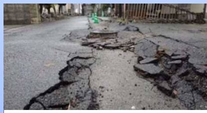
【熊本市内の被害状況②】
