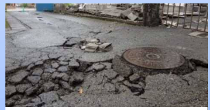
【熊本市内の被害状況③】
