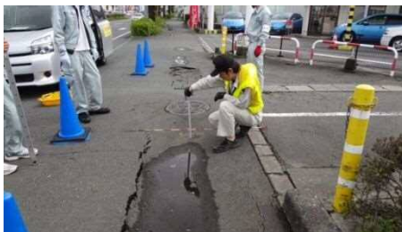
道路陥没調査
