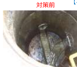
人孔内地下水流入箇所 （管口・人孔継ぎ部等）
