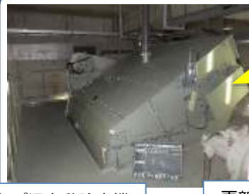
錦ポンプ場自動除塵機
