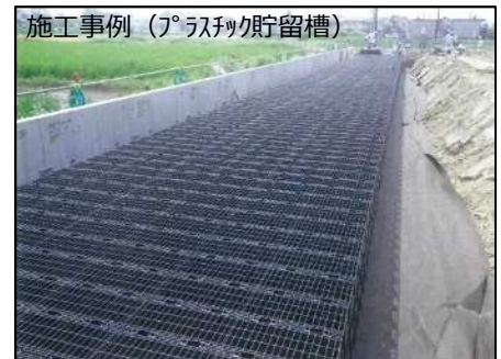
雨水流出抑制施設
