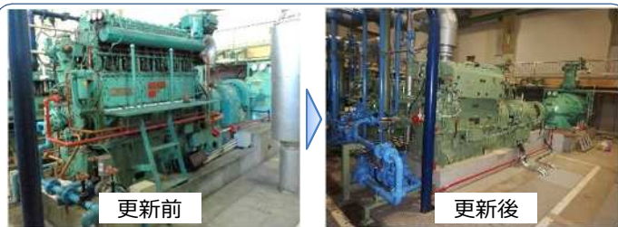
笹ヶ瀬P場雨水ポンプエンジン更新
