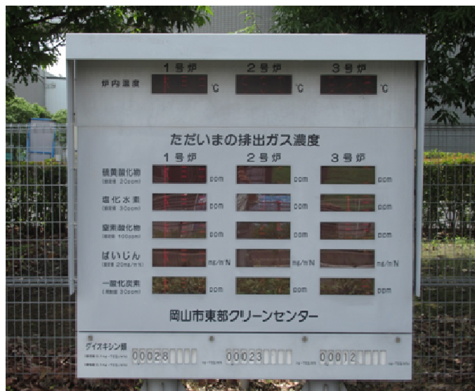
図 6-3 東部クリーンセンターに設置している排ガス濃度監視盤
