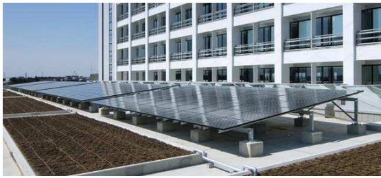
太陽光発電パネル（つくば市庁舎）
