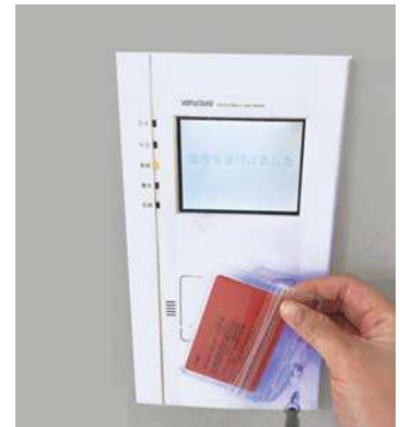
ICカードによる入室の事例
