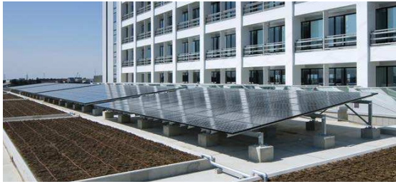
太陽光発電パネル（つくば市庁舎）
