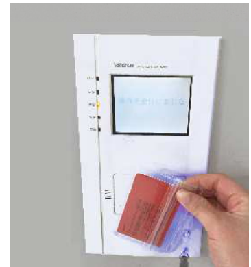
ICカードによる入室の事例
