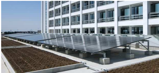
太陽光発電パネル（つくば市庁舎）
