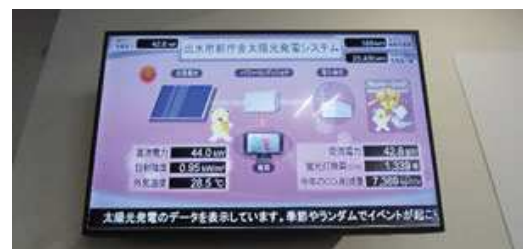
環境モニター（出水市庁舎）
