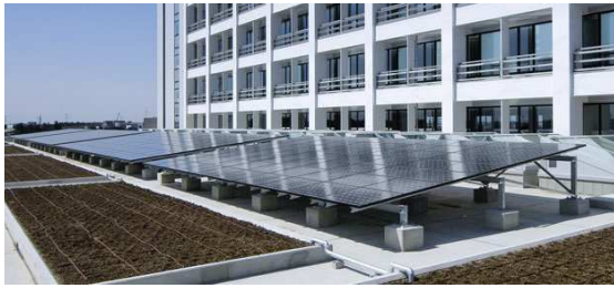
太陽光発電パネル（つくば市庁舎）
