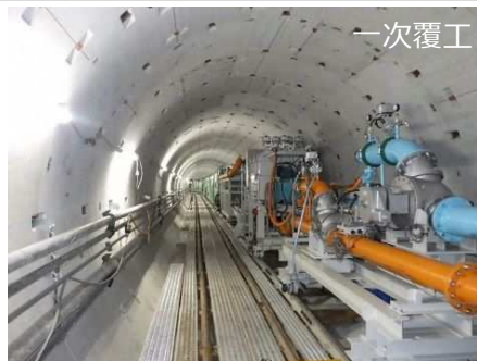
浦安11号幹線雨水管
