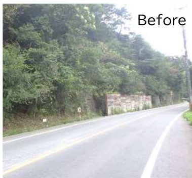
法面对策 県道金甲山線
