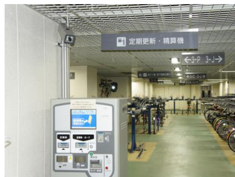
▲防犯カメラの設置
