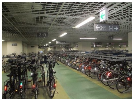
▲駐車場照明のLED化
