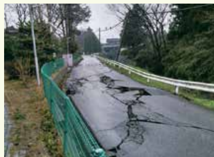
▲ひび割れた地面が非常に危険
