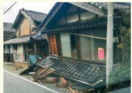
▲1階部分が倒壊した家屋
